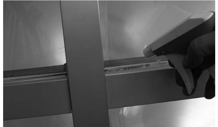
Abb. 33 Silikon vor dem Abstreifen mit Seifenwasser besprühen Fig. 33 Vaporiser la silicone à l'eau savonneuse avant de racler
