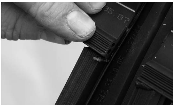
Abb. 60 Horizontaldichtung unten im Kreuzpunkt positionieren Fig. 60 Positionner le joint horizontal sous le point de croisée
