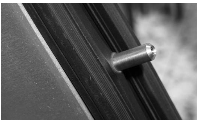
Abb. 33 Leichte Wölbung im Bereich der Brandschutzanker
