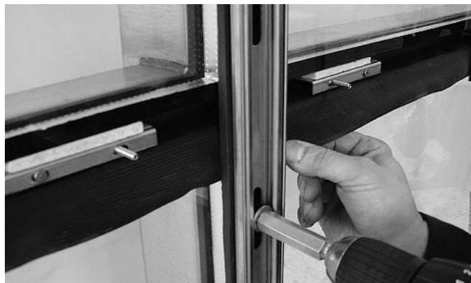
Abb. 34 Vertikale Anpressprofile anlegen und festschrauben. Bei den Riegel-Kreuzpunkten Dichtungslappen leicht nach unten ziehen. Fig. 34 Poser les profilés de fixation verticaux et visser à fond. Pour les points de croisée des traverses, tirer légèrement la languette vers le bas.
