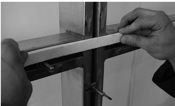
Abb. 3 Im Kreuzpunkt-Bereich werden die Keramikfaserbänder durchgehend aufgeklebt. Fig. 3 Les bandes de fibre de céramique de la zone de la traverse sont collées d'un bout à l'autre dans la zone du point de croisée.
