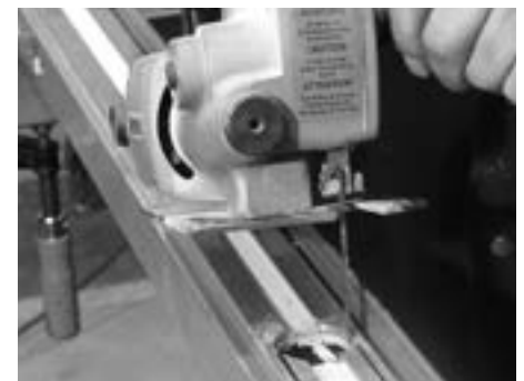
Ausnehmung mit Stichsäge ausschneiden Découpage de l'évidement avec un scie à guichet Cut out the recess using a jigsaw
